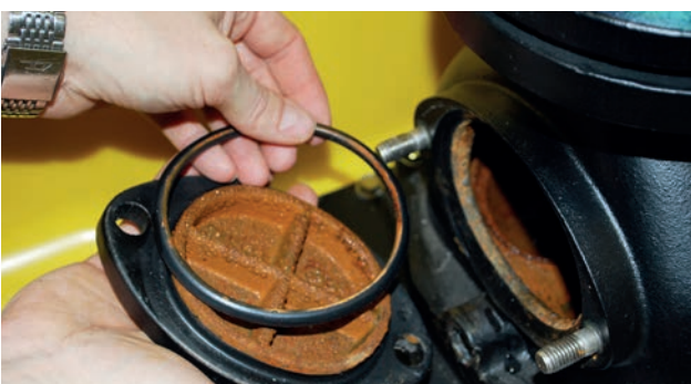
▶ Prüfung und Reinigung der Rückschlagklappe
