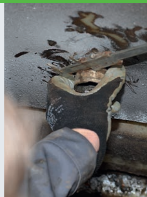
► Kürzen des Druckabgangs im Schacht
